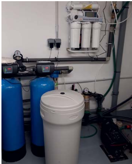
Kolona reverzní osmózy pro demineralizaci vody A reverse osmosis column for demineralising water
